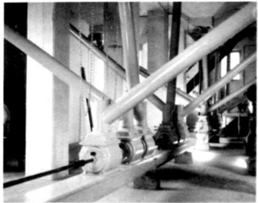
Verteilungsapparat im Silo
